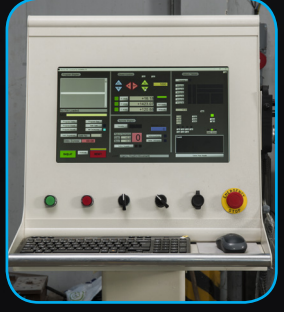
PC Tabanlı Kontrol Ünitesi
